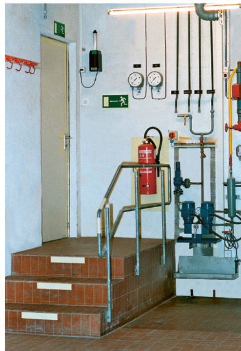
4 Beispiel einer Kennzeichnung mit Leuchtbändern (Situation bei Tag)
