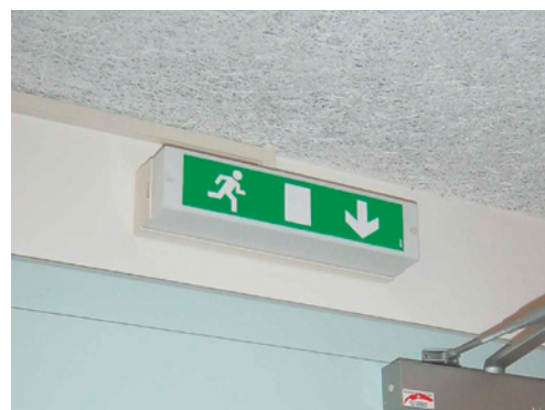
6 Beispiel einer Notbeleuchtung
